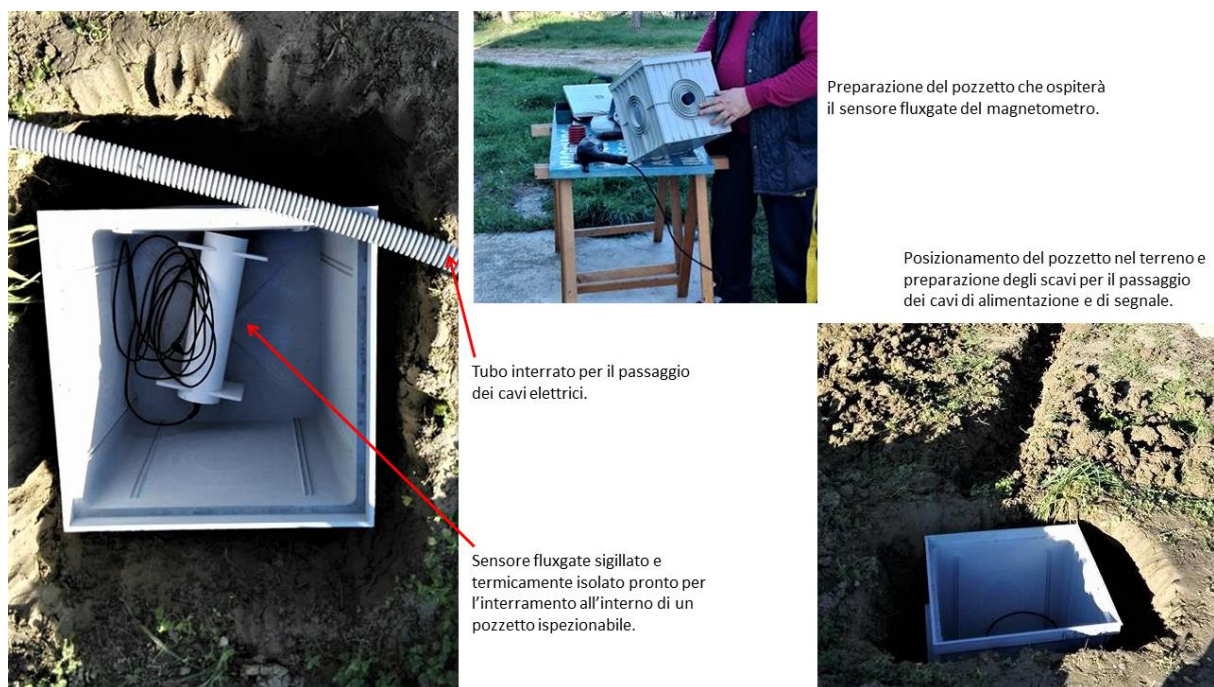
Fig. 11: Installazione del sensore fluxgate (prototipo di magnetometro RALMAG che misura solo la componente orizzontale Y del campo magnetico locale, in direzione EST-OVEST) all'interno di un pozzetto interrato presso l'Osservatorio Astronomico gestito dal Gruppo Astrofili “N. Copernico” in località S. Maria del Monte a Saludecio (RN). Lo strumento è stato posizionato in una località remota “magneticamente quieta”, distante da disturbi di origine antropica e industriale, particolarmente adatta ad un monitoraggio continuo delle perturbazioni geomagnetiche indotte dall'attività solare. Lo strumento “collabora”, con altri dispositivi appositamente sviluppati (ricevitori in banda VLF, HF e VHF – Fig. 10), ad un programma di ricerca sui disturbi geomagnetici e ionosferici causati dall'attività solare.
